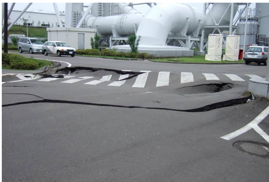
図5 原発敷地内で生じた地割れ
